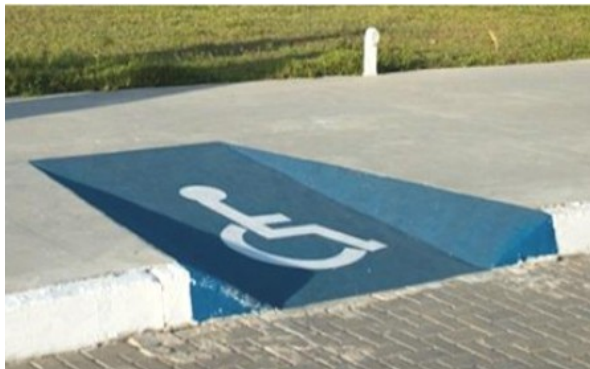
Rampa Tipo I, sinalização e pintura padrão internacional.
